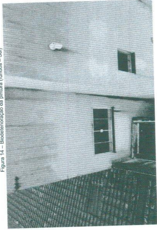
Figura 14 – Biodegradação da pintura (fundos – Sul)
